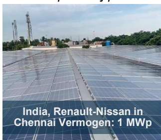
Figuur 5.2 – Solar carports bij private bedrijven / industrie
