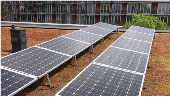
Figuur 15: De combinatie van groen en PV aan de weesperzijde in Amsterdam (via solarsedum.nl )
