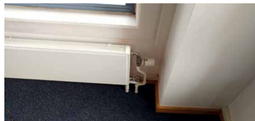
Er wordt voor de verwarming overgestapt van warmtekrachtkoppeling naar stadsverwarming, waarbij de bestaande radiatoren kunnen worden hergebruikt.
