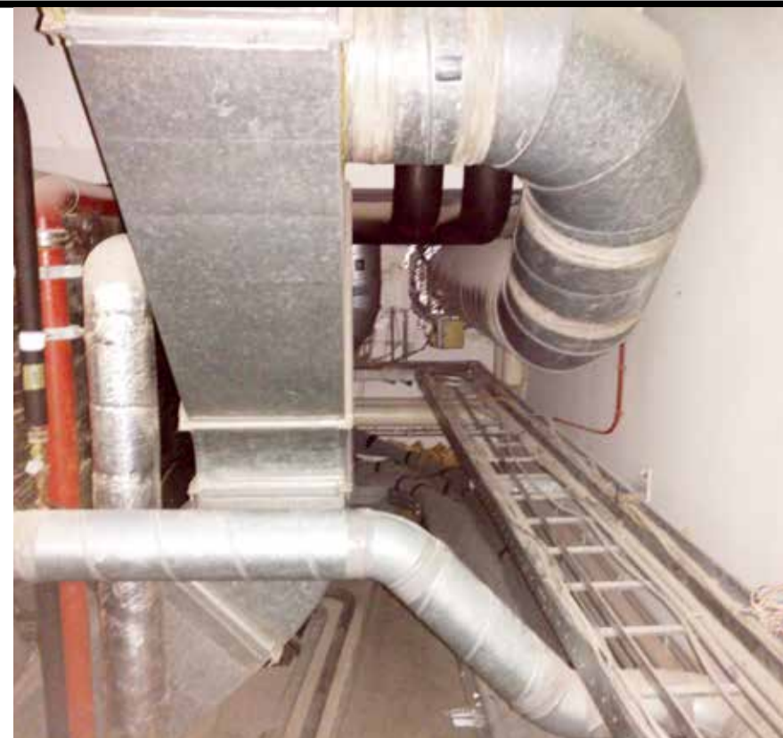
Voor de internationale school is gekeken naar een combinatie van circulariteit en duurzaamheid, waarbij technische installaties en materialen worden hergebruikt, zoals bestaande leidingtracés en kanalen.
