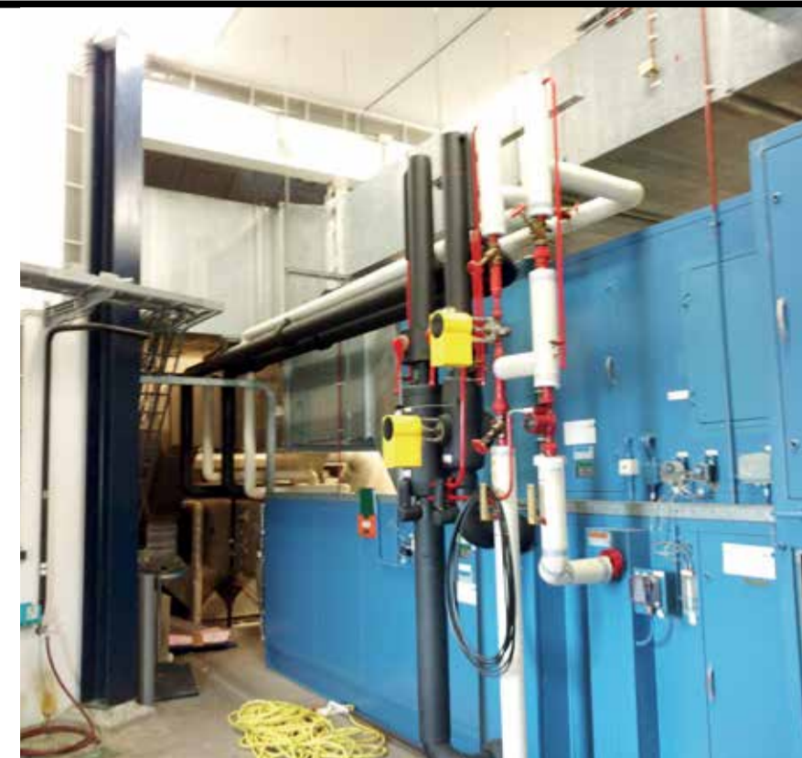
De luchtbehandelingskasten zijn stuk voor stuk onderzocht op hergebruik na bijna 35 jaar; ze kunnen worden gereviseerd en uitgebreid met warmteterugwinning.
