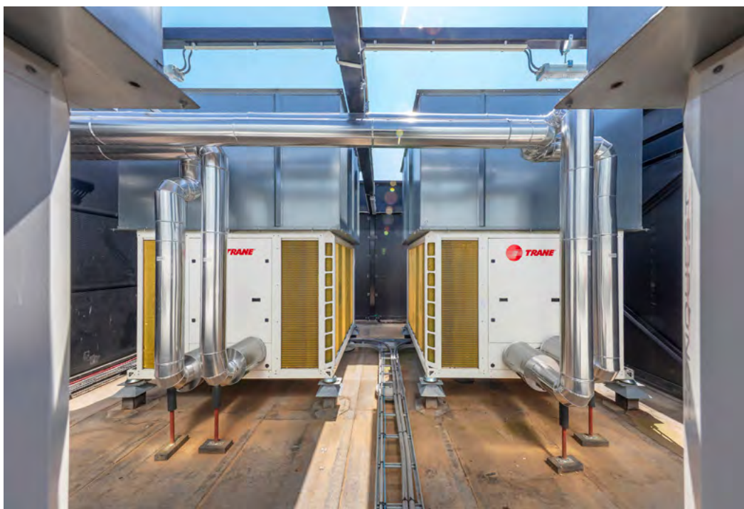
Foto 6: Op het dak van de nieuwbouw zijn 2 warmtepompen in buiten opstelling geplaatst, met een akoestische wand en aan de buitenzijde voorzien van PV-panelen.
